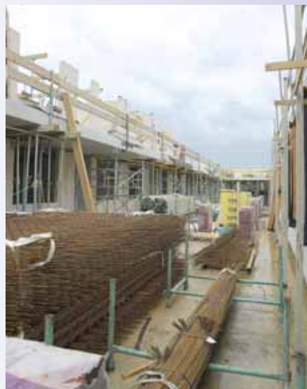
De galerij op de 1ste verdieping met links de oostvleugel en rechts de westvleugel.
