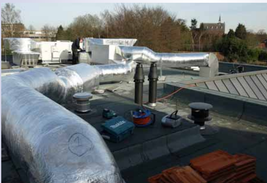
Dak van de nieuwbouw met veel installatiewerk voor mechanische ventilatie. Op de achtergrond de kapel van St. Jozef.
